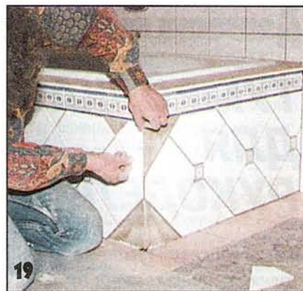
19 Сначала в верхней части каркаса ванны приклеили бордюр, затем квадратные плитки, располагая их диагонально.
